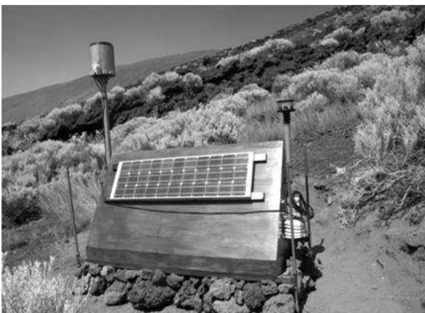
Fig. 11. Imagen de la estación geoquímica automática HIE07 en Tacorón.
