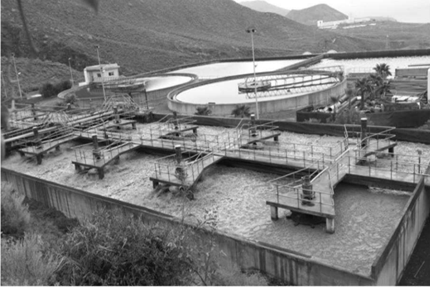
Fig. 4. Reactores biológicos de lodos activos y clarificadores secundarios al fondo, en un sistema de lodos activos convencional.
