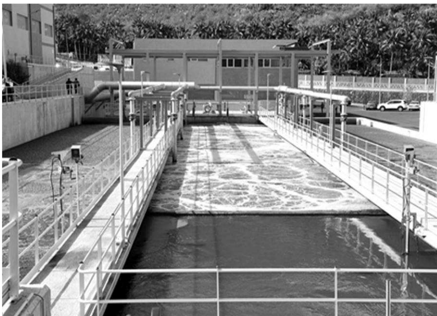
Fig. 6. Biorreactor de membranas de la EDAR del Noreste de Tenerife con tanque de membranas al fondo.
