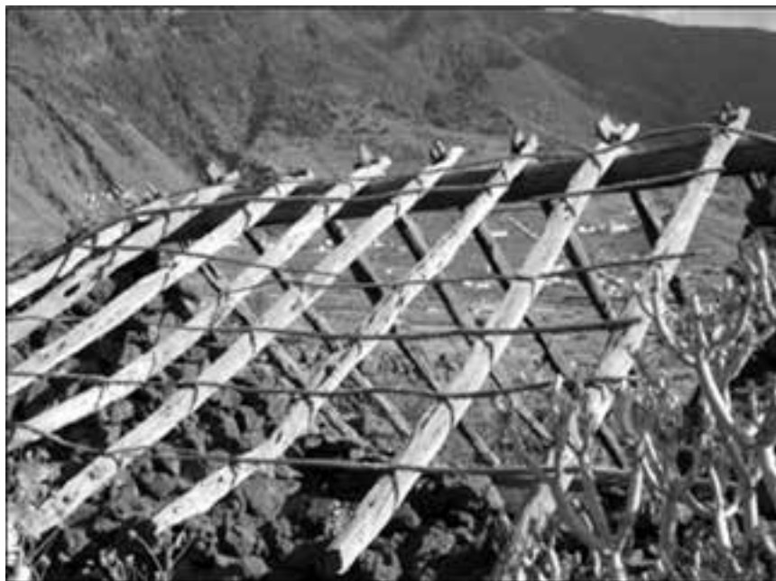
Fig. 6. Pajero abandonado cerca del poblado de Guinea, en La Frontera. Los rastreles desnudos, sin colmo ni tejas, y las paredes semiderruidas invadidas por la vegetación natural, evocan tristeza.
